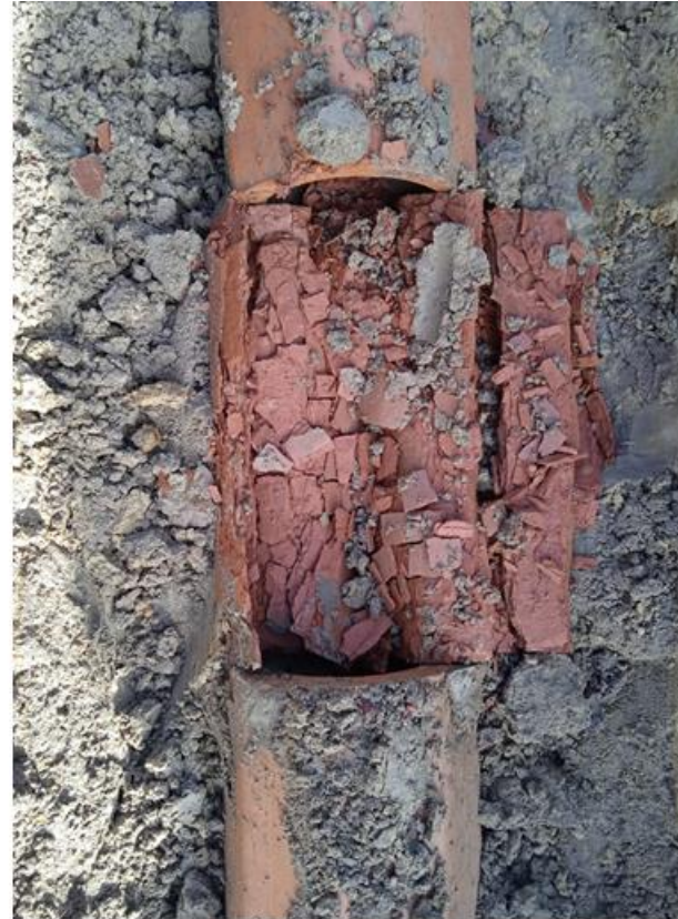
Rys. 3.11. Fragment uszkodzonego rurociągu drenarskiego; źródło: Gminna Spółka Wodna „Kampinos”
