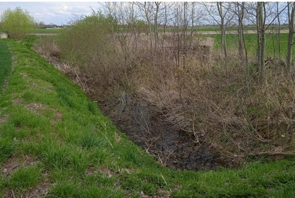
Rys. 3.13. Rów melioracyjny przed konserwacją, Wiejca, 04.2022; źródło: Gminna Spółka Wodna „Kampinos”
